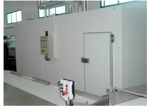
6 Túnel de congelación
